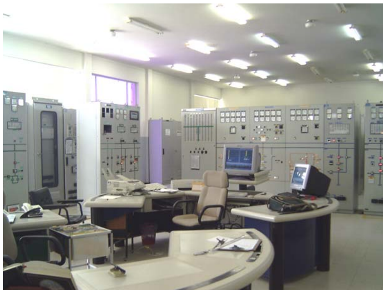
Figura 29: Sala de Operação de uma Subestação
