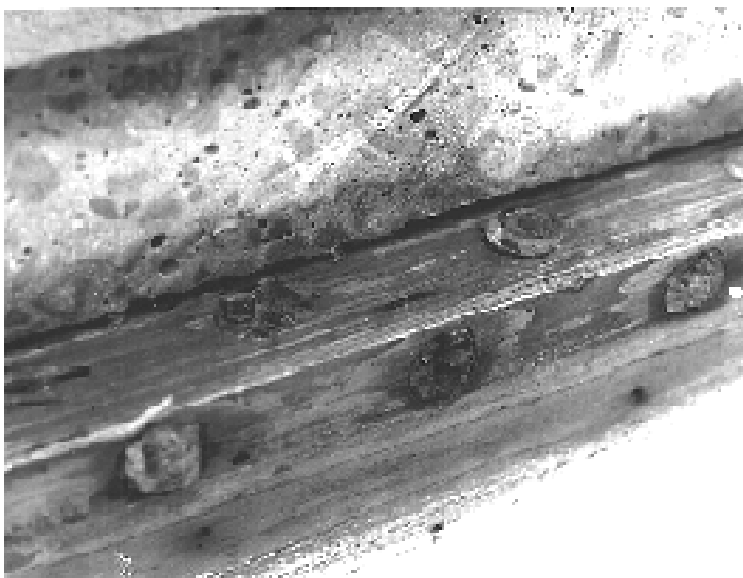
Figura 2.37 – Destruição das cavilhas depois do carregamento. Fonte: YTTURUP & NOLAN (1999)
