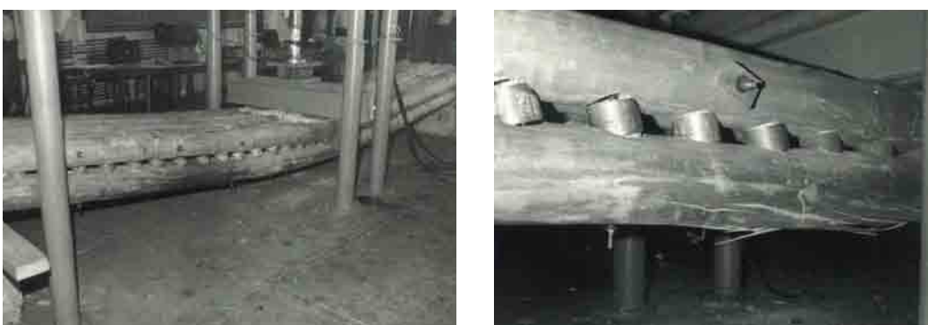
Figura 2.30 – Ruptura da ponte de postes de madeira. Fonte: MATTHIESEN (1987)
