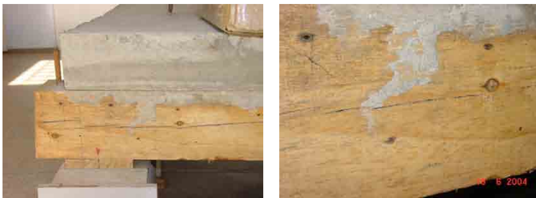
Figura 2.52 – Detalhe do cisalhamento na madeira. Fonte: SOUZA (2003)
