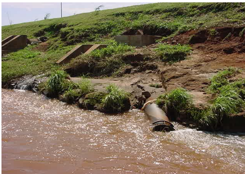
Figura 04 - Lançamento de esgoto - ETE-Salgado Filho no Córrego Anhanduí Fonte - Arquivo pessoal, (2006).
