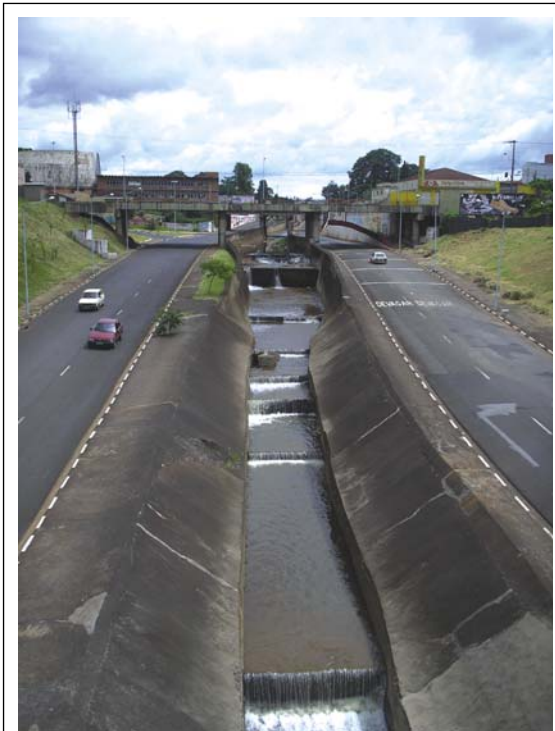
Figura 45. Canalização do córrego dos Bagres na avenida Hélio Palermo, após destruição da cachoeira.
