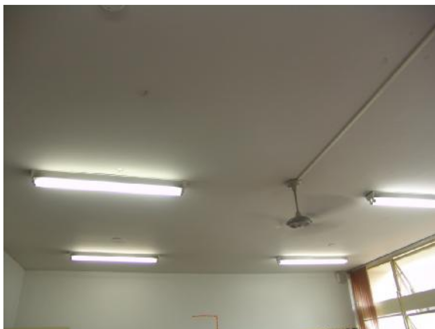
Fotografia 35. Sistema de Iluminação Artificial empregado na EC 410 Sul
