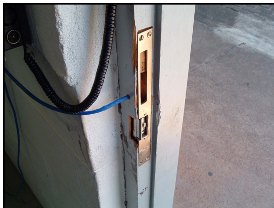
Figura 4.29 : Fecho eletromagnético instalado na batente da porta do laboratório de pesquisa.
