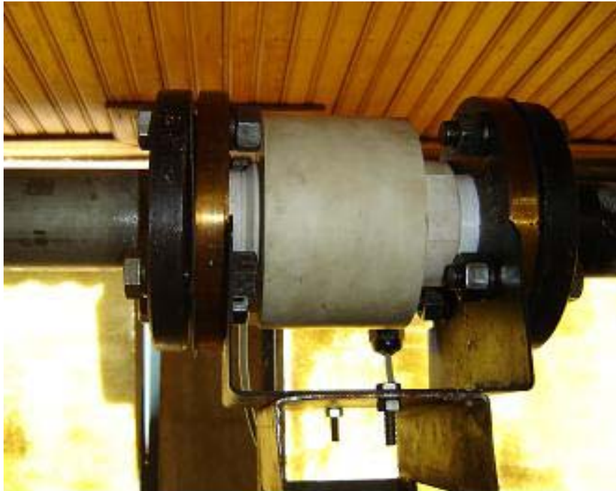
Figura 3.11 – Local de instalação do medidor de vazão, MV, na tubulação de recalque.
