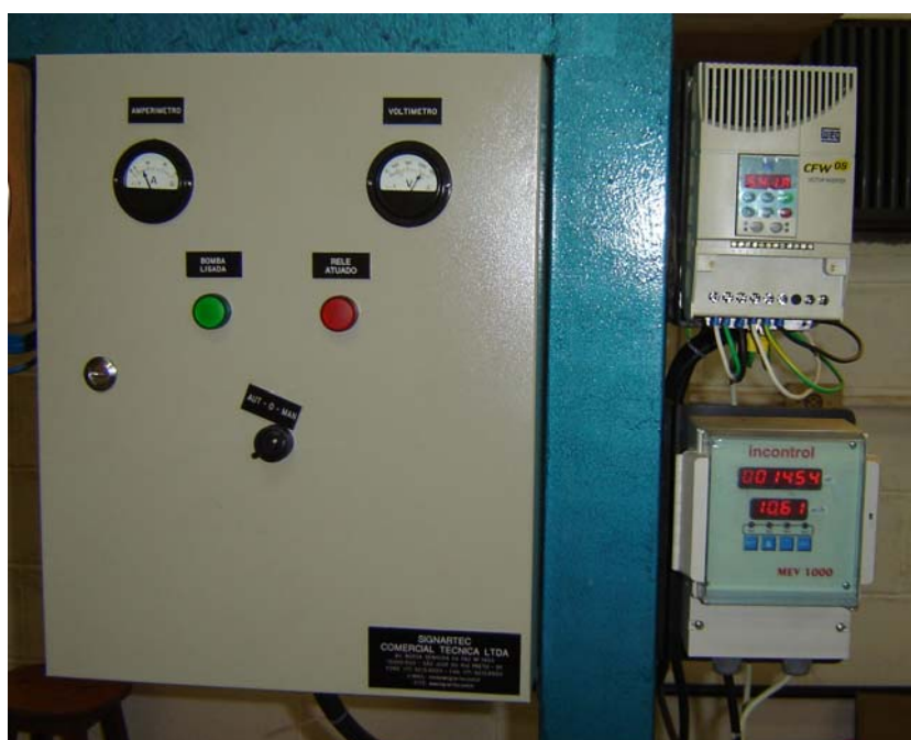
Figura 3.7 – Localização do painel elétrico, do inversor de frequência e do totalizador de vazão.
