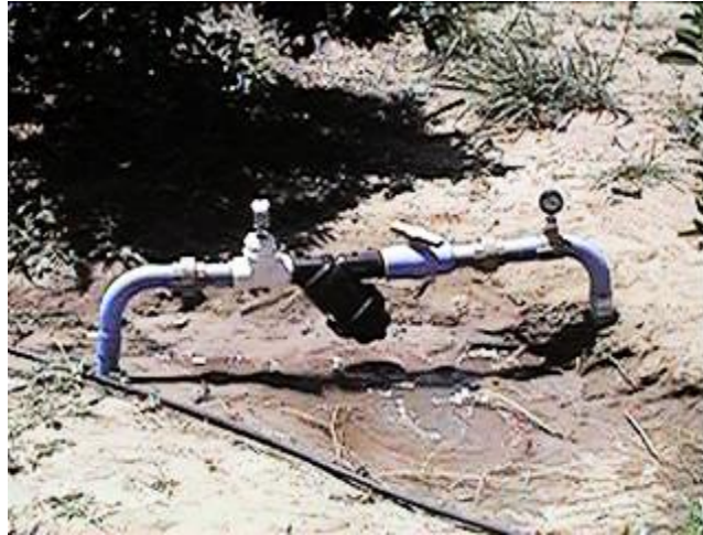
Figura 32 - Cavalete no início da linha de derivação
