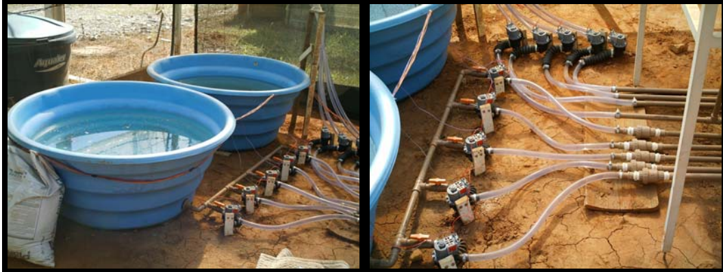
Figura 4 - Reservatório e sistema de bombeamento de água
