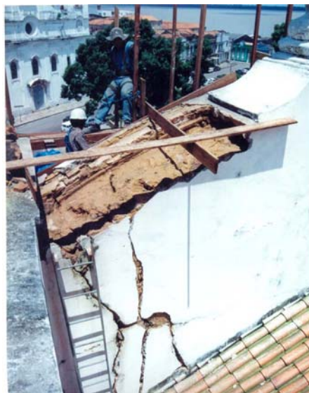
Figuras 33 e 34: Trincas Estruturais.
