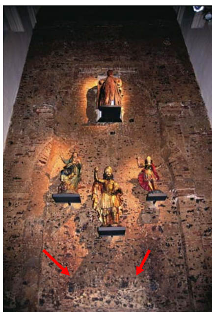
Figura 97 – Parede descarnada do transepto
