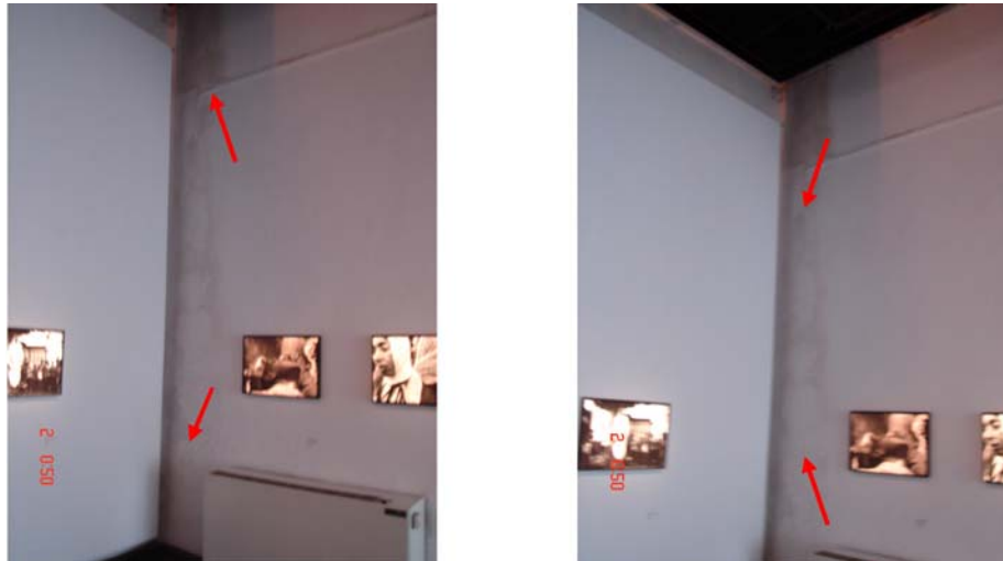
Figuras 65 e 66 – Manchas de umidade nas paredes
