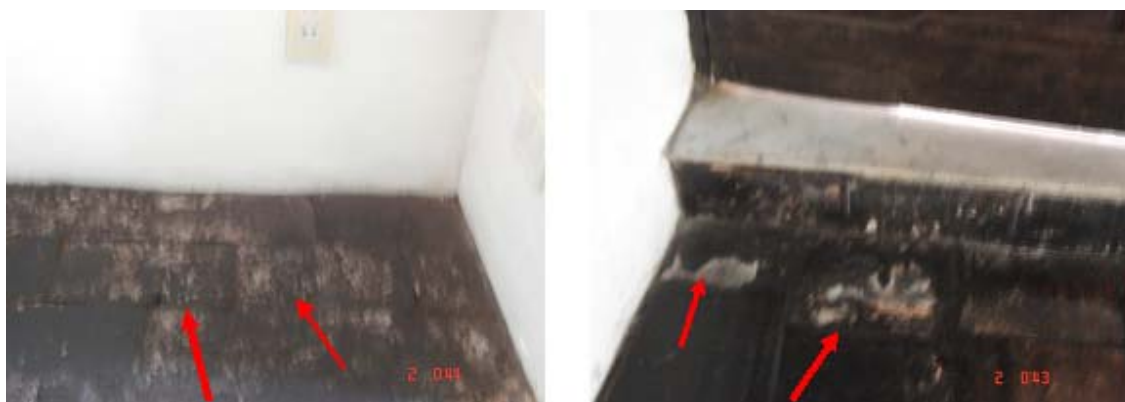
Figuras 61 e 62 – Manchas esbranquiçadas no piso em tijoleira.
