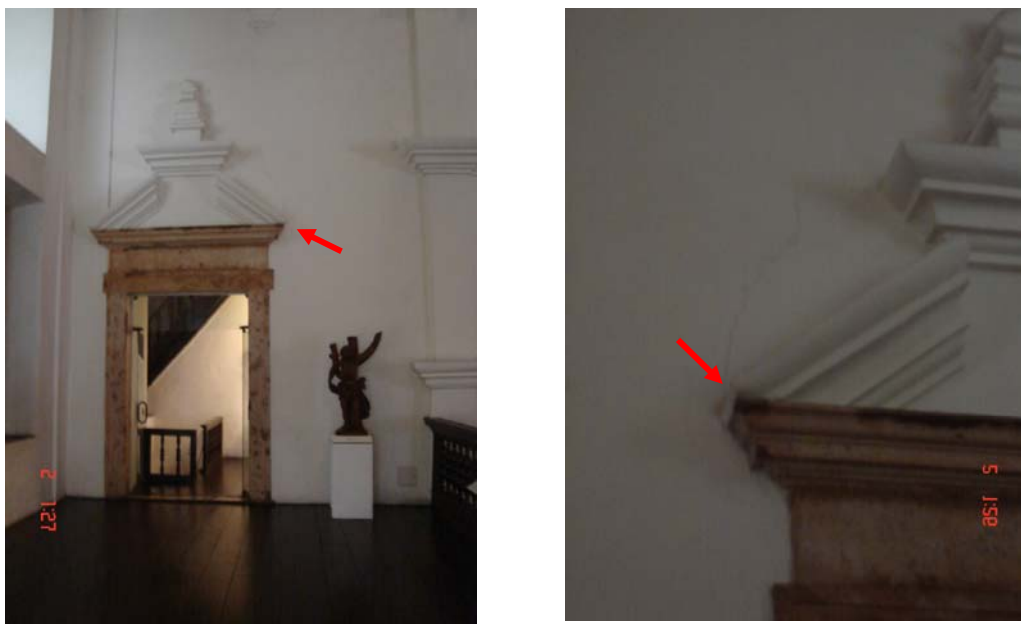
Figuras 111 e 112 – Fissura
