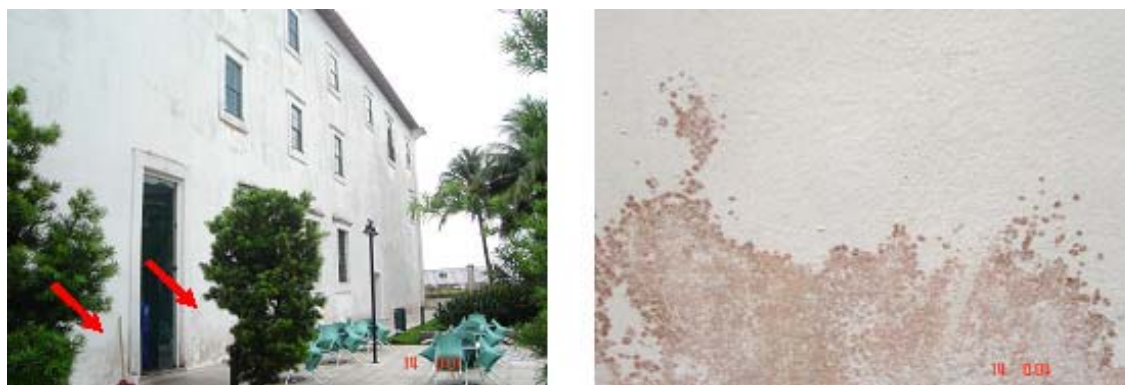
Figuras 74 e 75 – Detalhe da mancha de umidade
