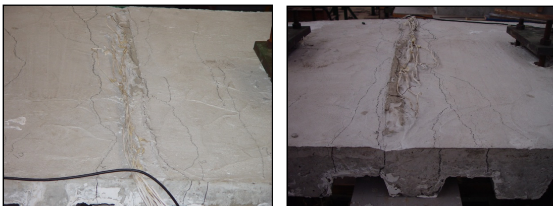
Fig. III-22 Estado de fissuração estabilizado e extensão das fissuras: ligação 2(b).
