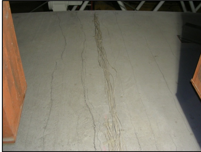
Fig. V-64 Processo de fissuração estabilizado na laje.
