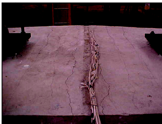
Fig. III-21 Estado de fissuração estabilizado e extensão das fissuras: ligação 2(a).
