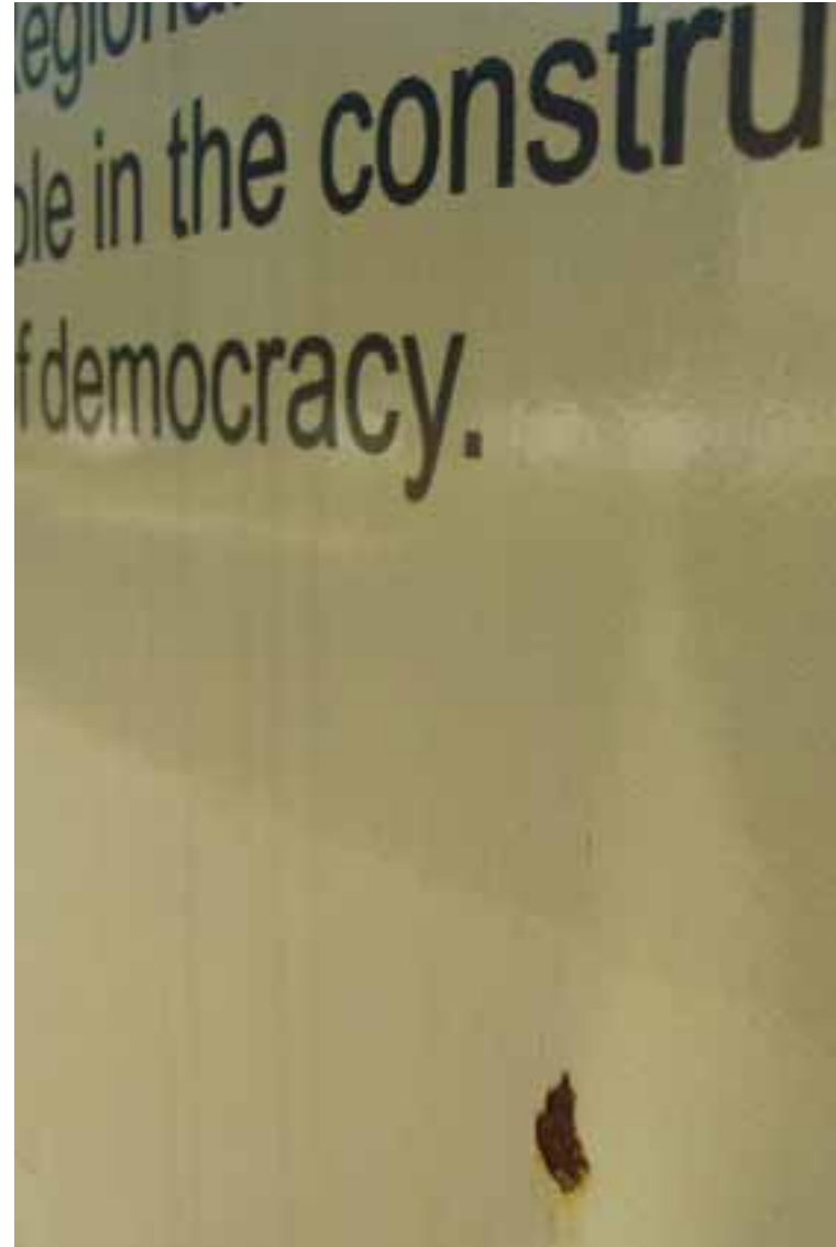
foto 213 O vinil de pouca resistência soltando da placa metálica.
