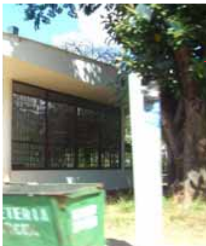
foto 205 Sinalização de pedestre prevista mas não executada conforme o plano e a peça indicativa de quadra que requer manutenção a mais de 8 meses.
