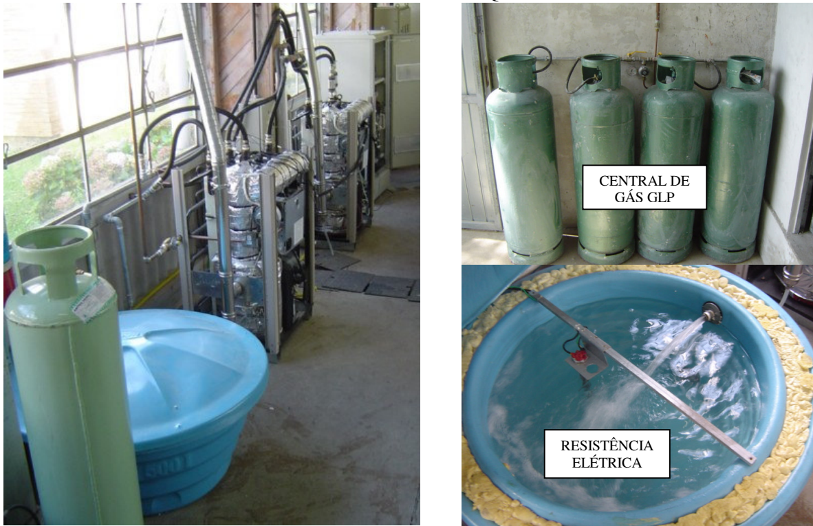
FIGURA 4.3 – VISÃO GERAL DA INFRA-ESTRUTURA PARA OS EQUIPAMENTOS
