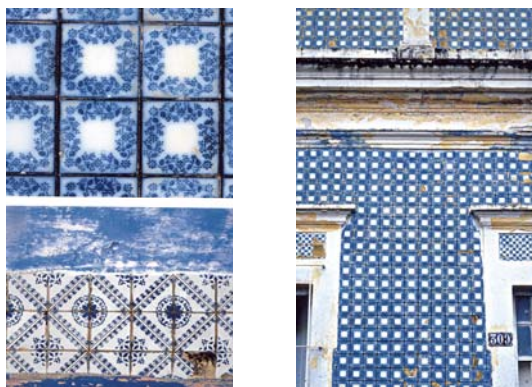
Ilustração 4 - Azulejos – Rua da Glória, 300- Recife- PE Fachada revestida de azulejos franceses 11x11 cm e detalhes da fachada. Fonte: CAVALCANTI, 2002, pg. 68/69.
