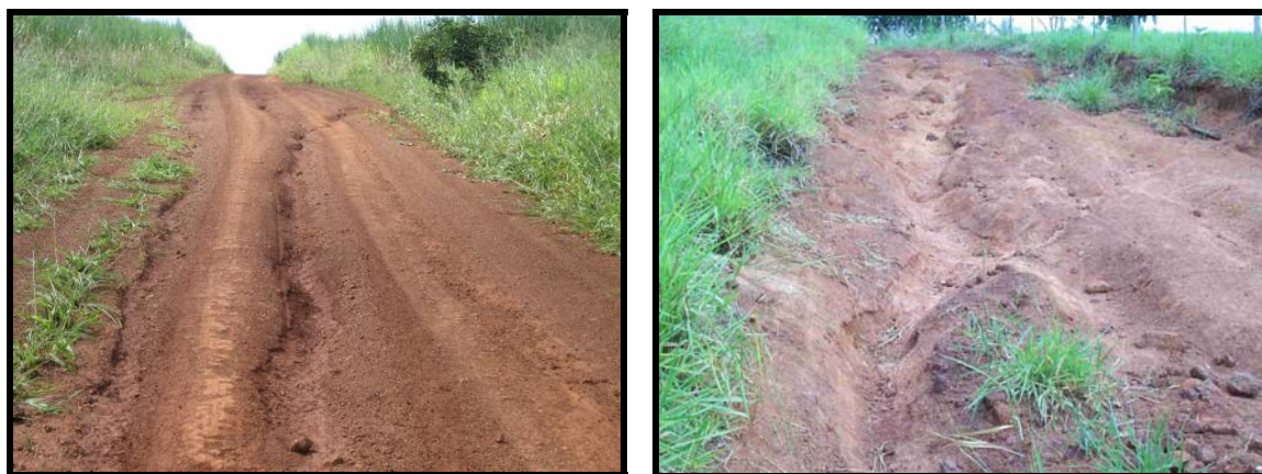
Figura 17. Estrada com sulcos em estágio avançado.
