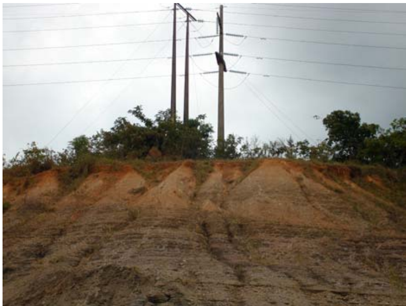
Figura 21. Início de processo erosivo nas encostas da jazida e próximo de postes de energia elétrica do bairro em que está inserida
