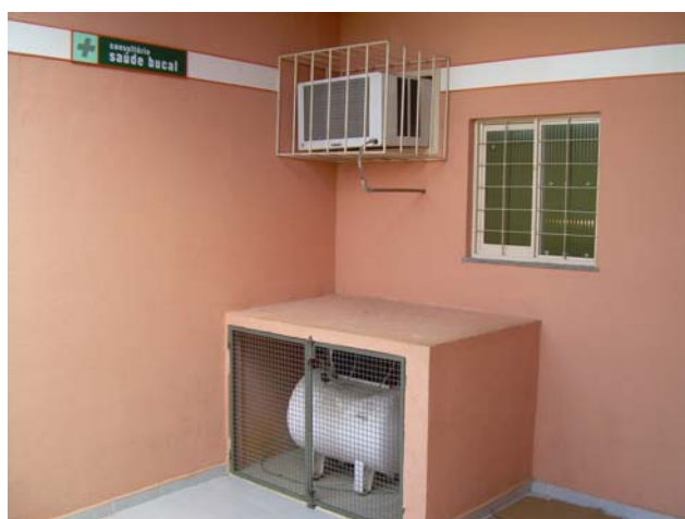
Fig. 57 – Vista do exterior da edícula construída fora da Sala de Saúde Bucal para abrigar o compressor.
