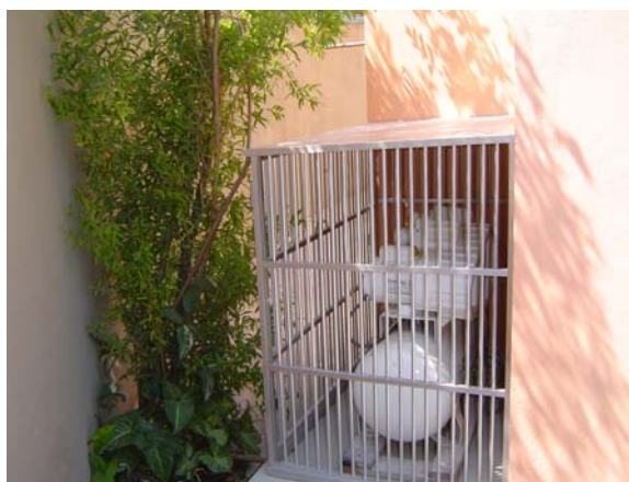
Fig. 36– Detalhe do compressor de ar comprimido da sala de saúde bucal, localizado na área externa do PSF.
