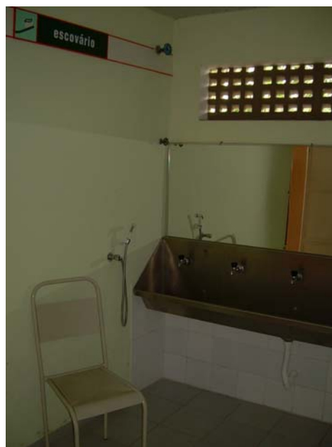
Fig. 21 – A área do escovário possui ventilação natural permanente, por meio de cobogós de concreto.
