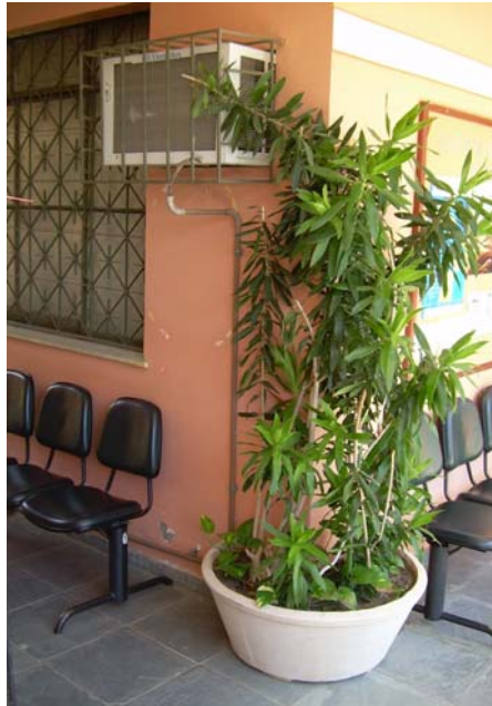
Fig. 41 – Detalhe do vaso de canto sob a grade do ar condicionado.
