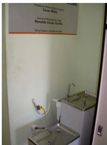
Fig. 64 – Detalhe do pré-filtro do bebedor.
