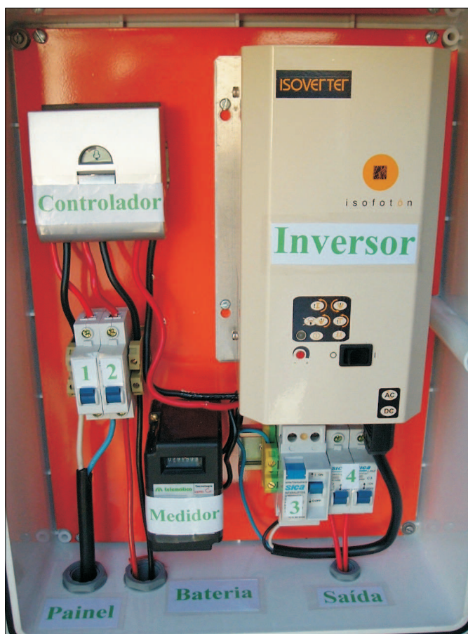
Figura 2.11: Quadro elétrico de controle do SFD.
