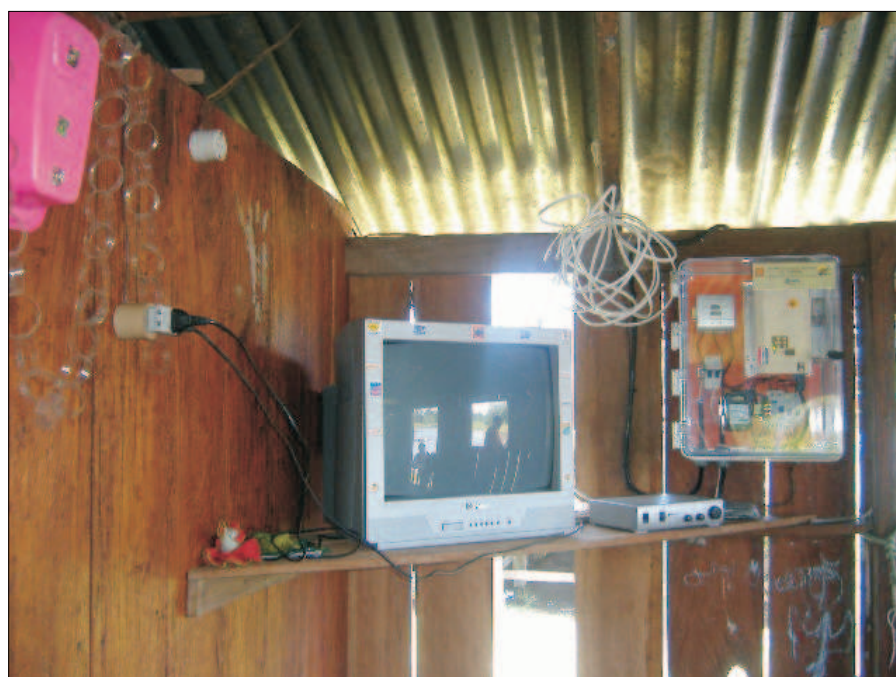
Figura 2.29: Quadro elétrico no interior de um domicílio.
