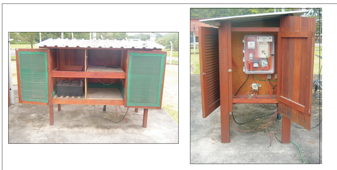
Figura 2.13: Baterias e quadro elétrico do protótipo.
