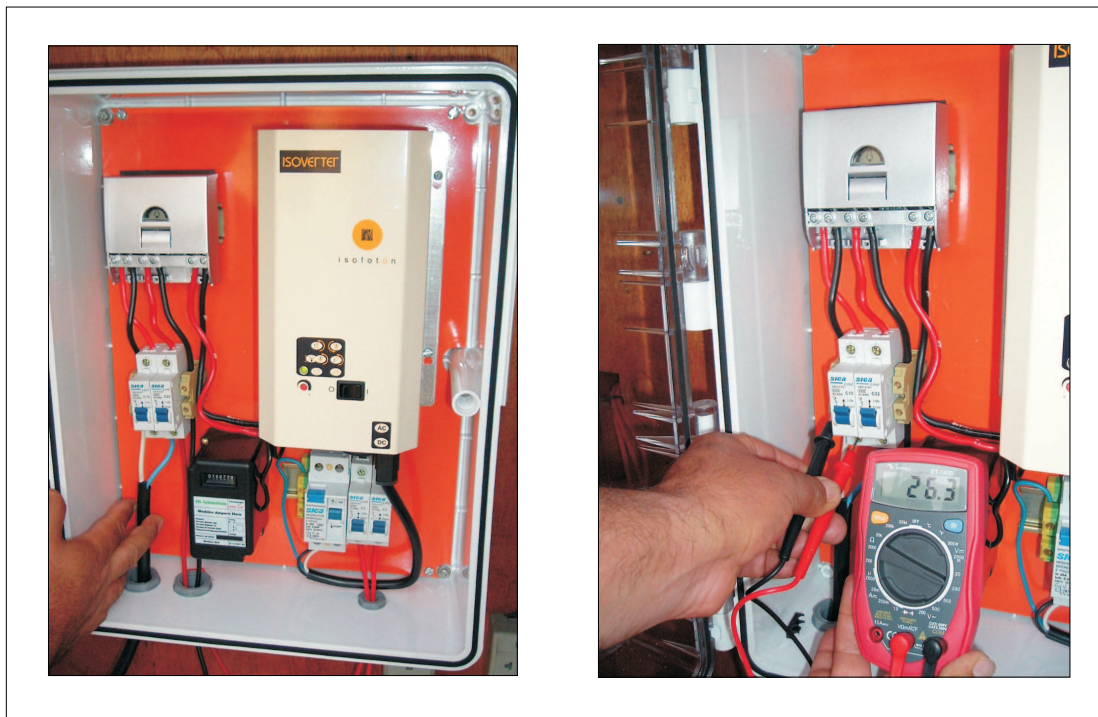
Figura 3.19: Medição da tensão do módulo fotovoltaico.
