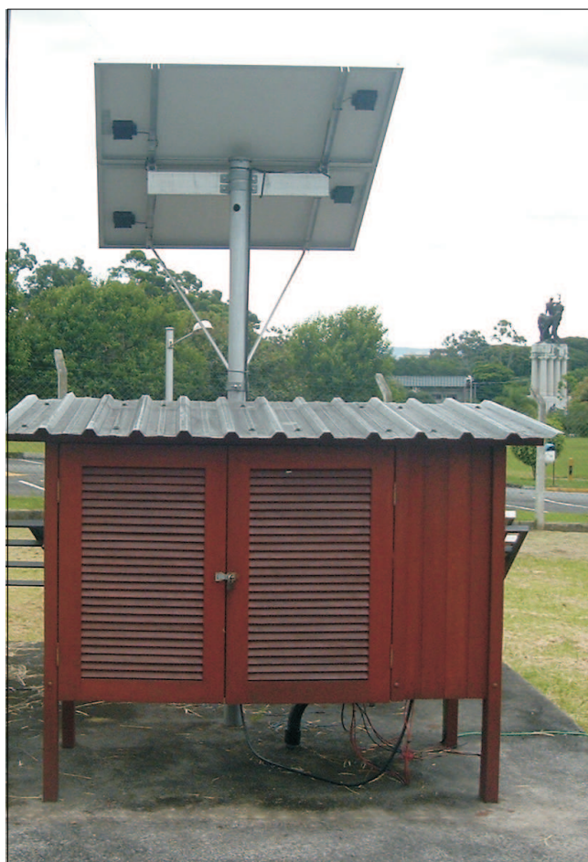
Figura 2.12: Protótipo instalado no LSF/IEE/USP.
