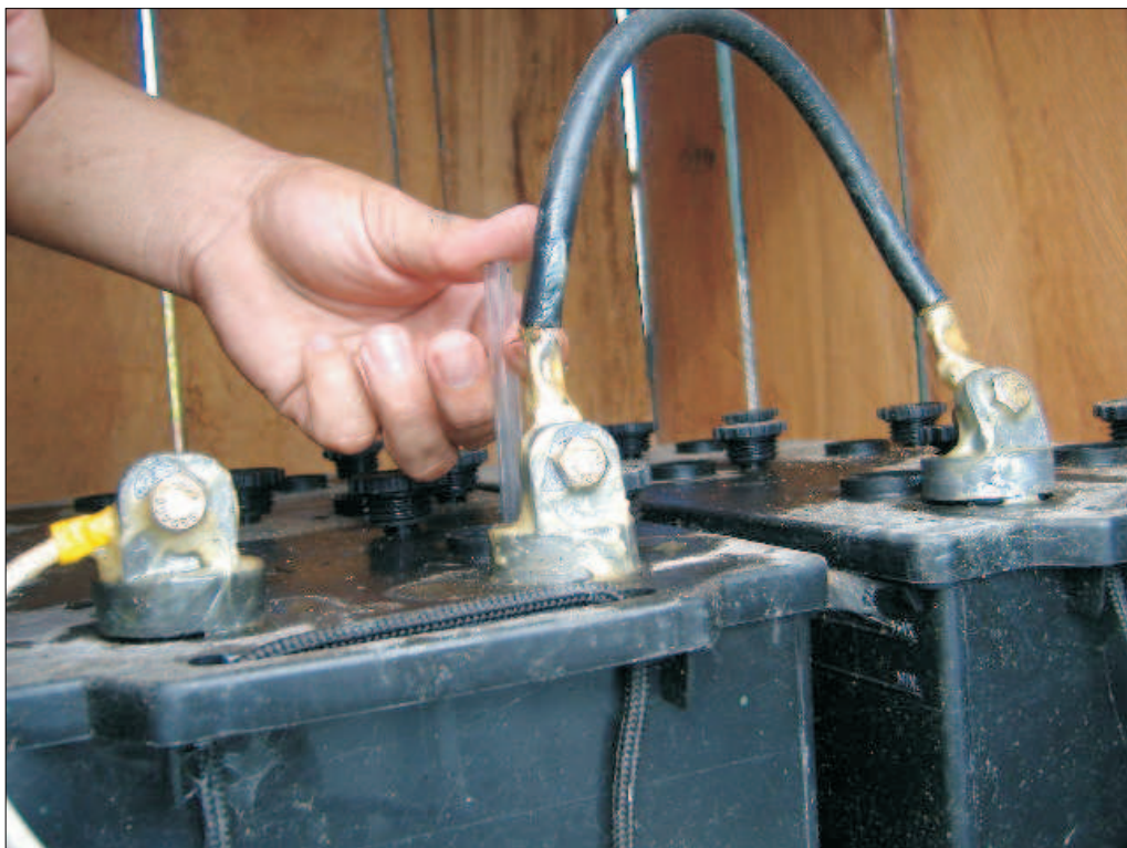
Figura 3.16: Medição do nível de eletrólito das baterias.
