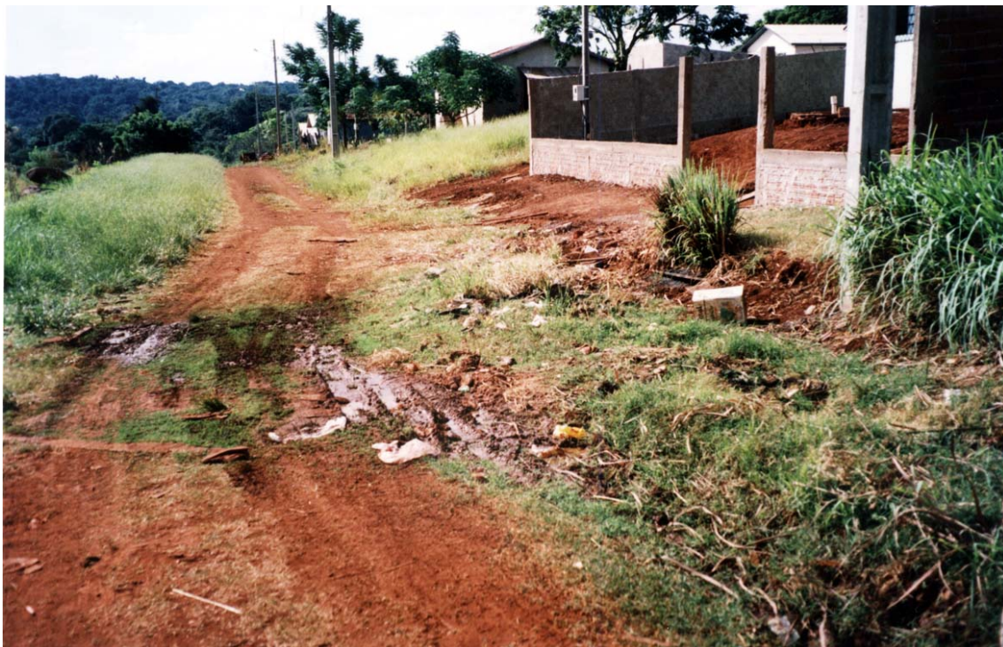
Figura 19 – Falta de saneamento básico, com as fossas vazando para o meio ambiente. Fonte: : UBS Iguacu, 2000.
