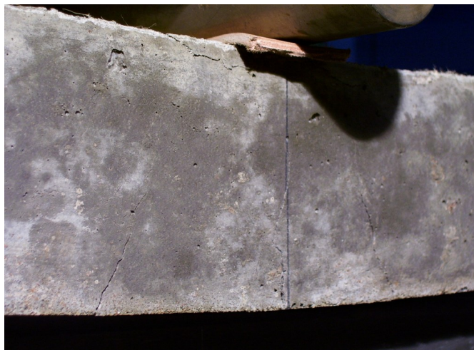
Figura 31: viga V1 no instante do esgotamento da capacidade de carga da viga
