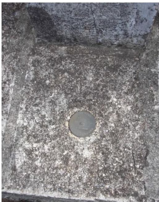
Figura 4.17: Chapa Terrafoto na base do pilar Valinhos. Fonte: Foto do autor.
