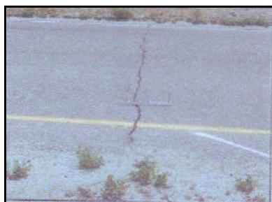
Figura I.14 - Trinca transversal no pavimento [DORANCHO, 2001]
