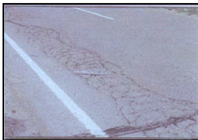
Figura I.13 - Trincamento do pavimento por fadiga [DORANCHO, 2001]
