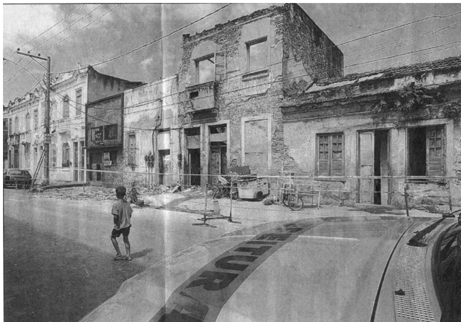
Figura 77. “Um carro da prefeitura passa em frente aos sobrados interditados após o desabamento parcial, no Centro” (O GLOBO, 2006). Foto: Marco Antonio Cavalcanti
