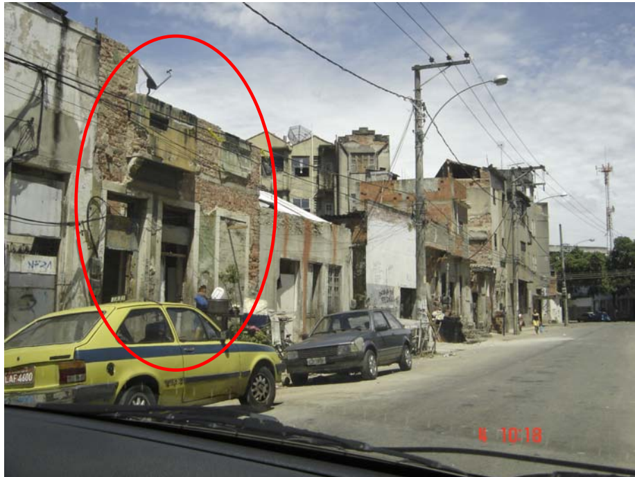
Figura 82: No destaque, o sobrado na Travessa Pedregais, nº 33 – Cidade Nova. Onze meses após seu desabamento parcial. Foto: Claudia Baima - fev/07
