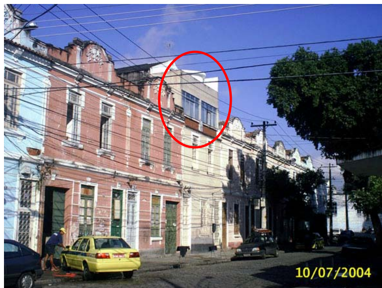
Figura 60: Casarios na Rua Senhor dos Matosinhos. No detalhe, pode-se perceber o “puxadicho” descaracterizando o conjunto. Foto: Claudia Baima – set/04
