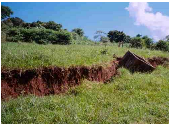
Area do Compartimento 6, onde no dia 20 de janeiro, após chuva intensa, o terreno cedeu de forma perpendicular deslocando-se de 0,50 a 2,20 metros para baixo.
