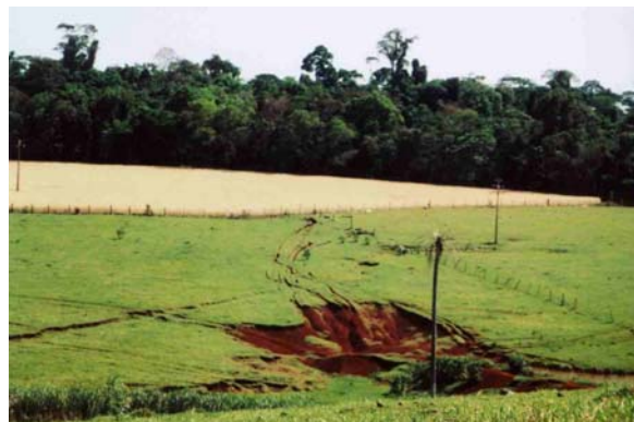
Area com avanço dos processo erosivos provocado pelo pisoteio do gado, no Compartimento 5.
