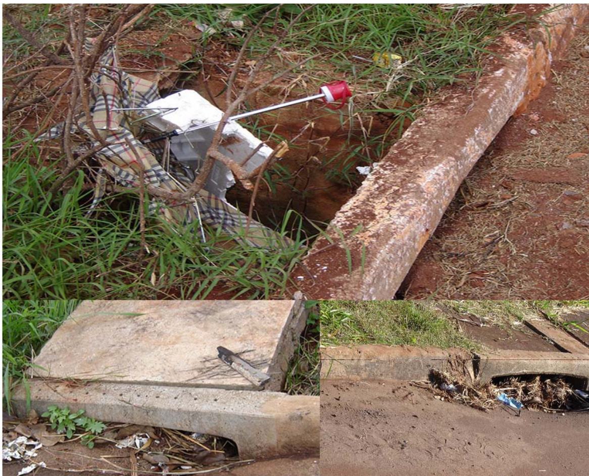
Foto 4.7 – Obstrução das galerias públicas de águas pluviais
