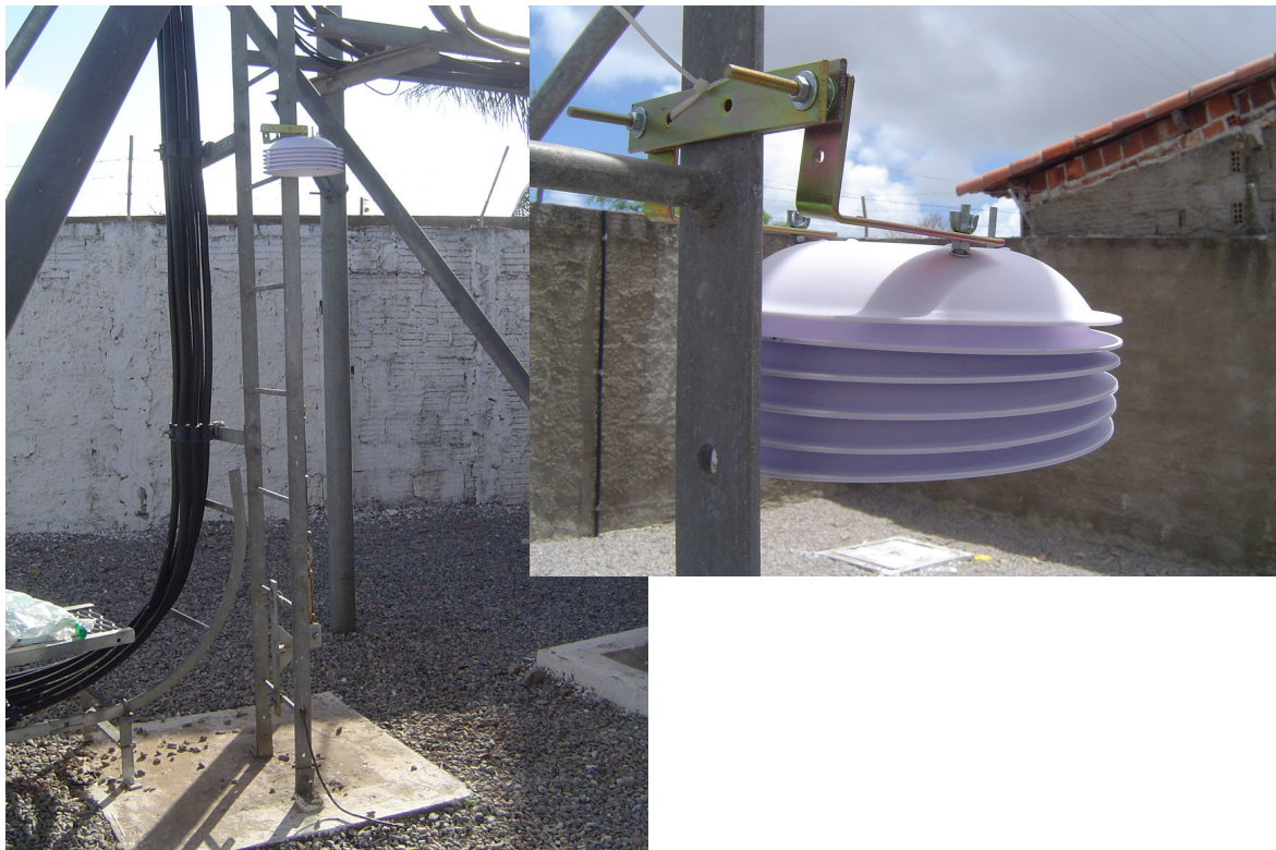
Figura 5.15 – Fotografias do equipamento instalado na escada e detalhe de fixação.
