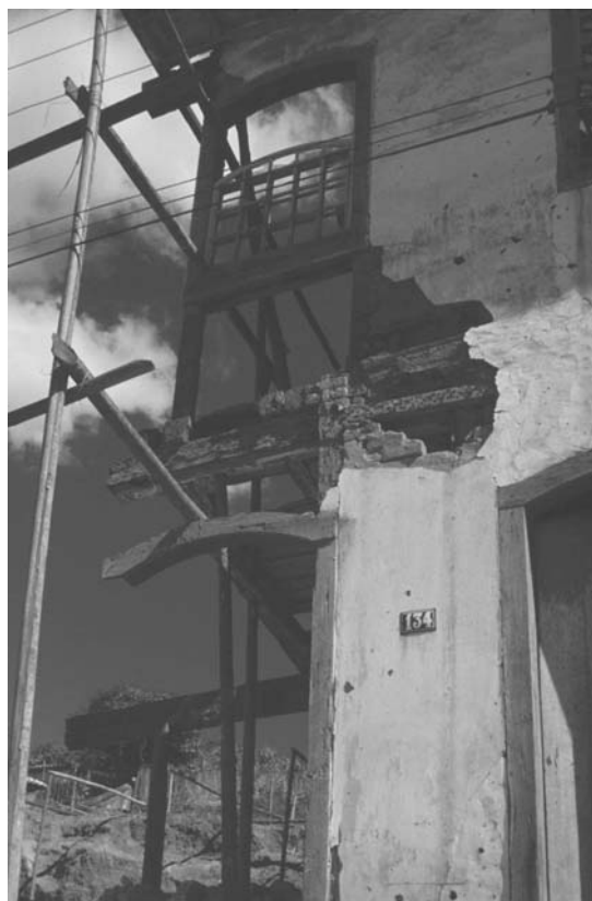
Figura 51. Sobrado em processo arruinamento. Fonte: Segawa (2004) – foto de 197?
