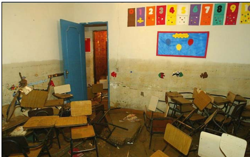
Figura 6.3 – Marcas da inundação em parede de escola (Fonte: O Globo, 30/11/2006, Fotogaleria “Chuvvas em Nova Iguaçu”)
