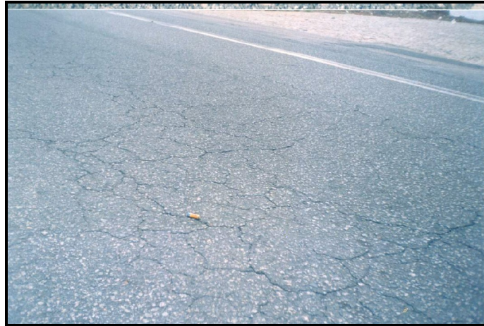
Figura 2.1 – Defeito em revestimento asfáltico: trinca em forma de couro de jacaré [Fonte própria]
