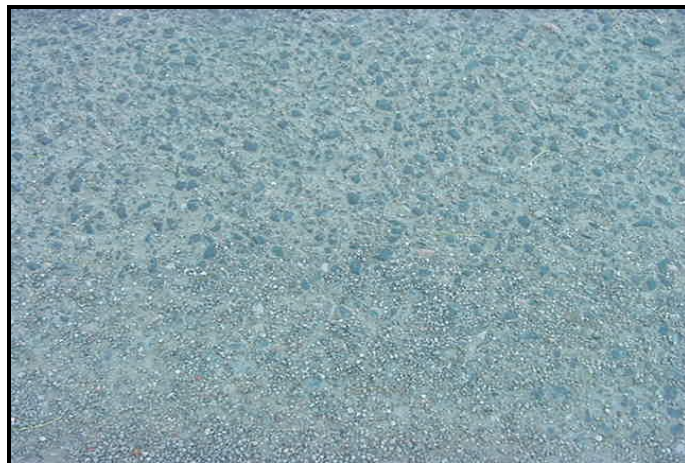
Figura 2.3 - Defeito em revestimento asfáltico: desagregação [Fonte própria]
