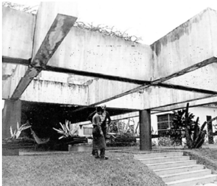
274 – Foto da varanda, é possível observar as redes ao fundo e a vegetação sobre as vigas. Fonte: MATTAR, 1999, p. 50.
