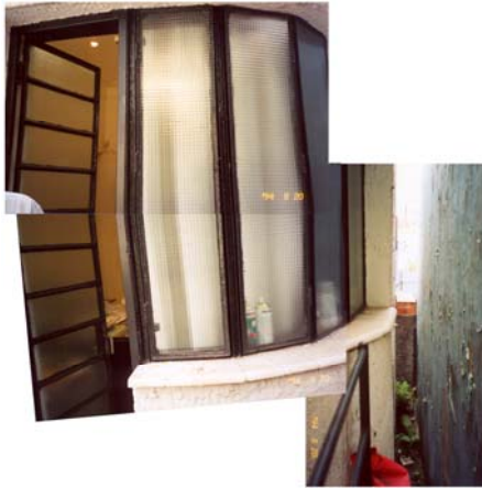
212 – Esquadrias das janelas e das portas são, em sua maioria, colocadas na mesma estrutura, encaixada posteriormente, vedando os vãos e aberturas
