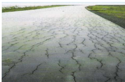
b) Fissurações longitudinais
