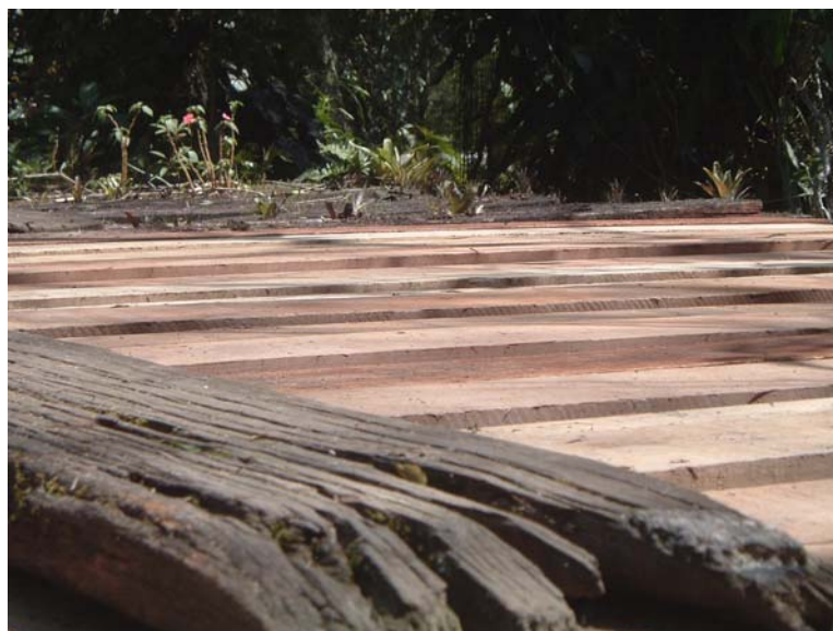
Fig. 34 – Reforma da ponte: a madeira foi adquirida pela Prefeitura e a mão-de-obra está sendo disponibilizada por moradores da Barreira.
