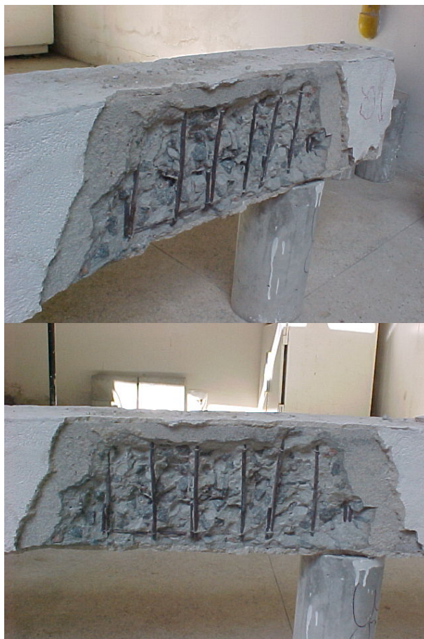
Figura 4.18 Lascamento(i.e. spalling) na viga C07 do experimento RECverm_60min
