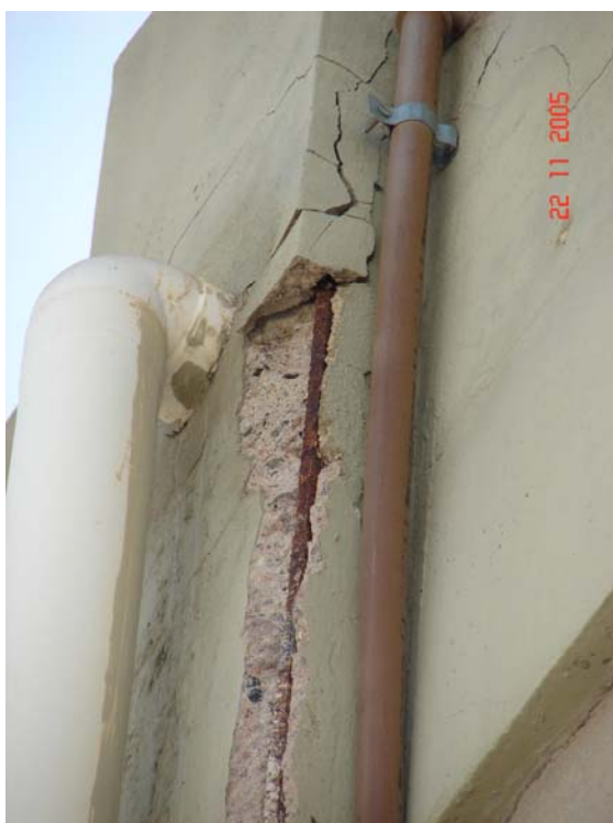
Figura 10 – Lascamento no Pilar P3 (Visão externa)
