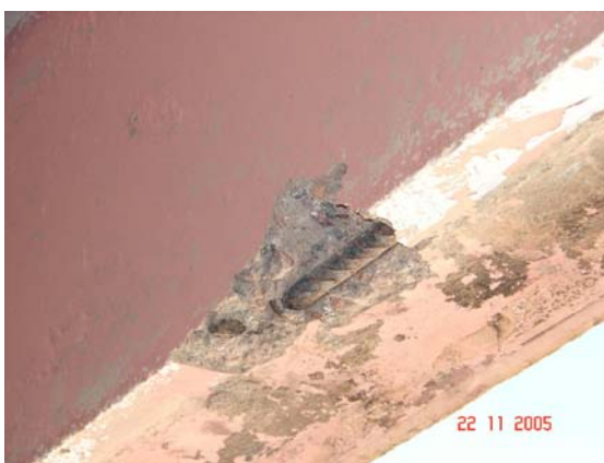
Figura 12 – Lascamento (2) na Viga V101 tramo c
