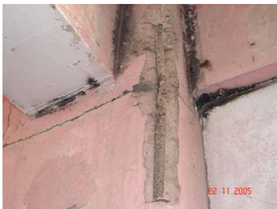
Figura 9 – Lascamento no Pilar P3 (Visão interna).
