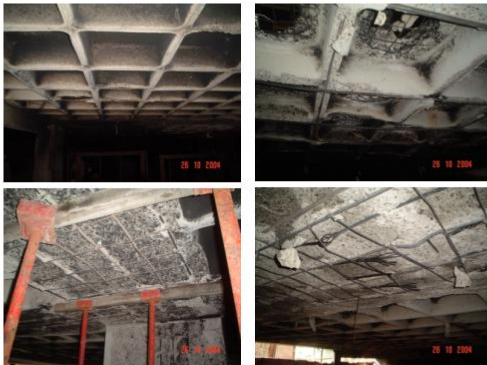
Figura 1.5 - Pavimento inferior de um edf. residencial após o incêndio Recife, Brasil (2004)
