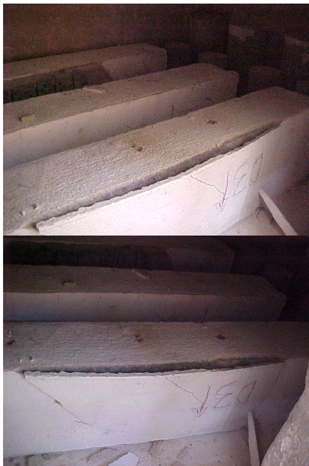
Figura 4.17 Desprendimento da vermiculita da face
