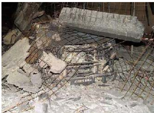
Figura 2.24 – Colapso parcial da estrutura dos anéis do Gotthard Tunnel induzidos por lascamento. Fonte: Costa et al (2002-b)
