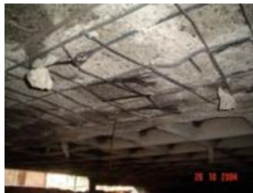
Figura 2.25 – Lascamento da laje de uma edificação – Recife (2004)
