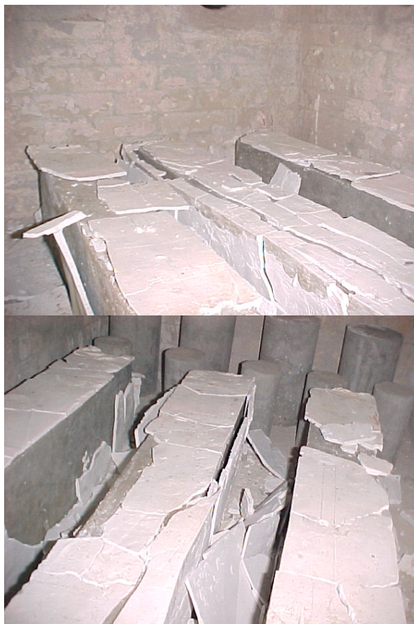
Figura 4.16 Fissuras no revestimento de gesso
