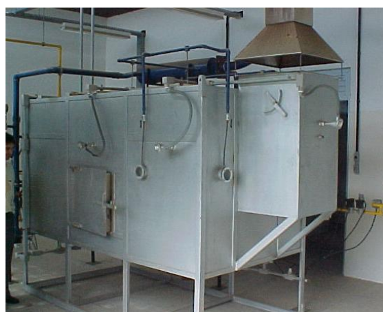
Figura 3.2 – Câmara de combustão utilizada nas exposições
