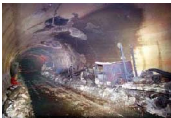
Figura 2.23 - Cavidades devido ao lascamento no Mont Blanc Tunnel – França/Itália (1999). Fonte: Costa et al (2002)
