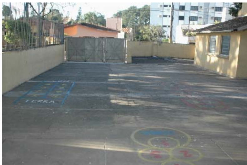
Figura 3. Piso cimentado com pintura desgastada no pátio da Escola Honorato Faustino.
