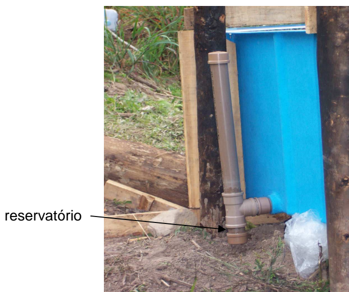
Figura 32. Aspecto do dispositivo de leitura da altura máxima de lâmina escoada em calha Parshall instalada a campo.
