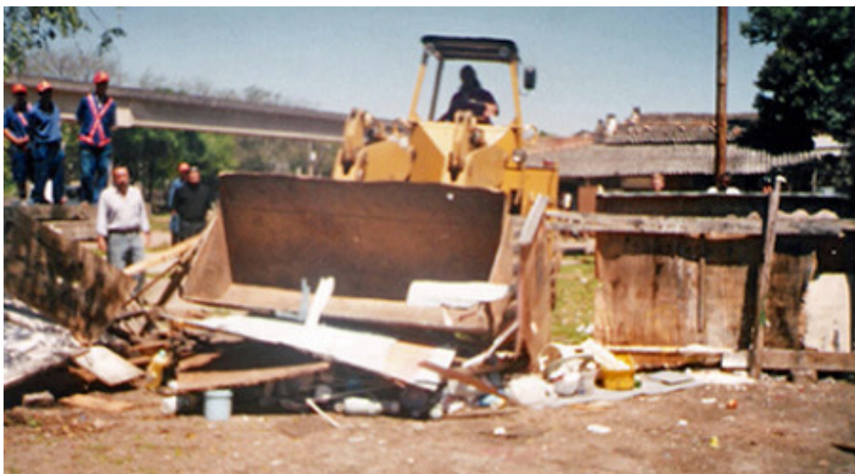
Figura 48 – Derrubada do cercado da casa de Sebastião e Márcio (16/10/2003).
