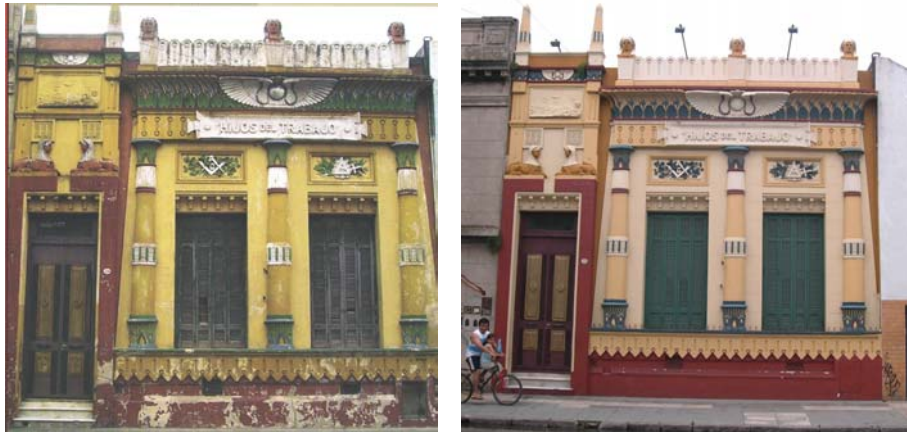
As imagens mostram o antes e o depois da restauração da fachada da Loja "Hijos del trabajo" localizada no bairro de Barracas. Foto 1: Carla Brocatto
