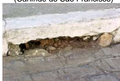
(f) Boca de lobo obstruída (Nossa Senhora da Glória)
