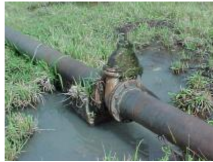
(b) Vazamento em adutora de água bruta (Rodelas-BA)
