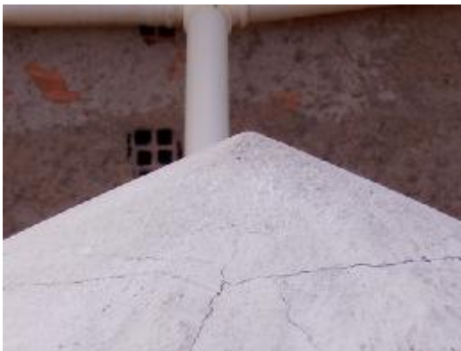
(c) Presença de fissuras
