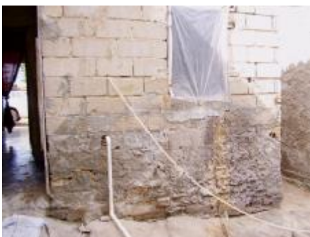
(a) Irregularidades e ausência de revestimento
