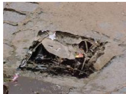
(b) Caixa de passagem com ferragem exposta (Terra Nova)
