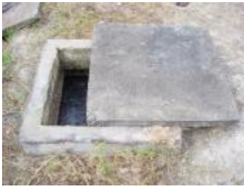
(a) Fossa séptica com laje fora de posição
