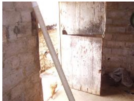
(f) Tubulação, que interliga a calha à cisterna, colocada no chão
