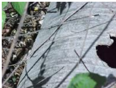
(a) Dano em rede coletora (Glória)
