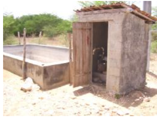
(b) Bomba do poço danificada (localidade Fazenda São Paulo)
