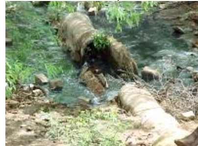
(d) Emissário de lagoa de estabilização avariada (Rodelas)
