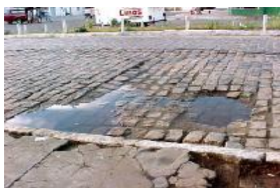
(e) Calçamento irregular (Monte Alegre de Sergipe)
