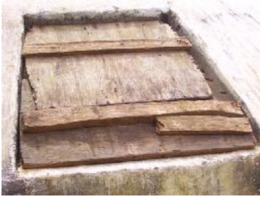
(a) Tampa deteriorada
