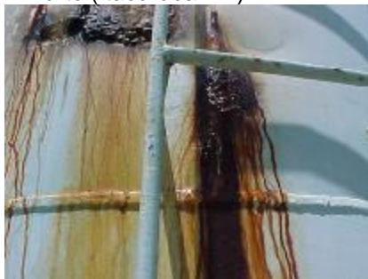
(c) Estrutura deteriorada de um filtro de ETA (Glória-BA)
