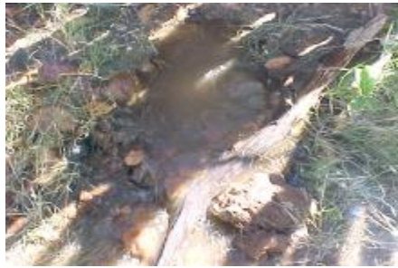
(a) Adutora de água bruta de PVC avariada, devido à prática de furto (Itacuruba-PE).
