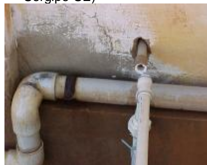
(f) Tubulação de alimentação do clorador desconectada (Petrolândia)
