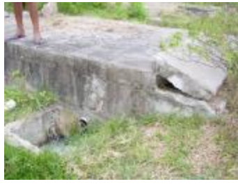
(b) Filtro anaeróbio com laje avariada
