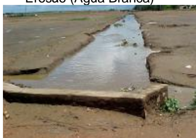
(c) Canal na iminência de transbordar (Cabrobó)
