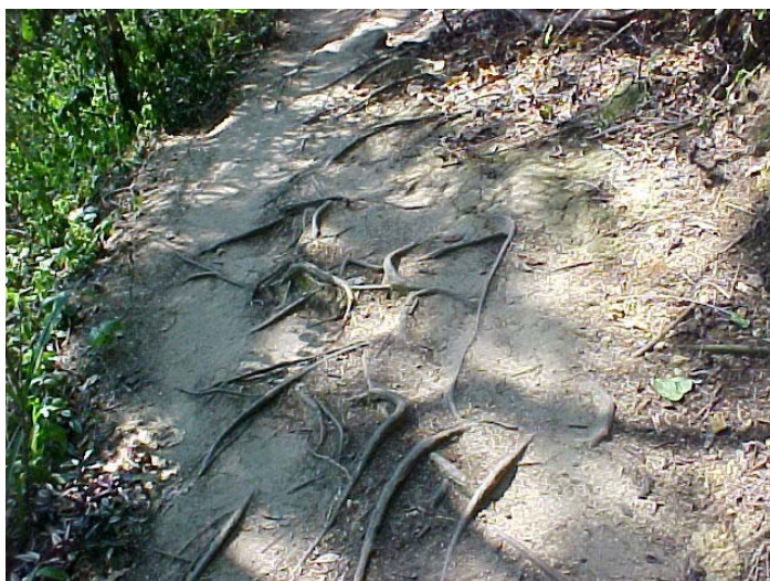
Figura 20: Raízes expostas na trilha para Praia da Crena, 2000. Fonte: Alexandre Oliveira
