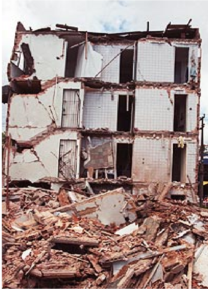
Figura 1.4 – Edifício Éricka após o desastre
