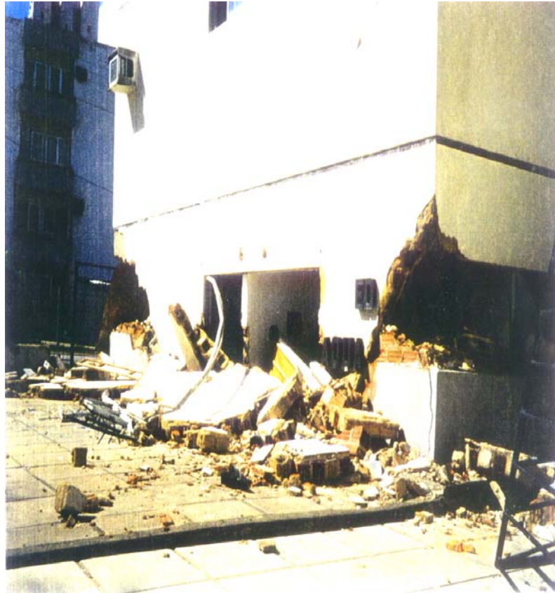
Figura 4.2 – Edifício Aquarela após o acidente
