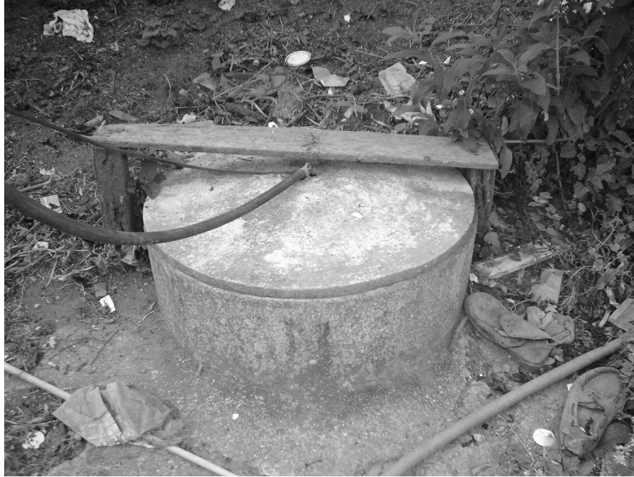
FIGURA 12: Vista externa de uma cisterna revestida, tampada, com borda elevada, mas rodeada de lixo
