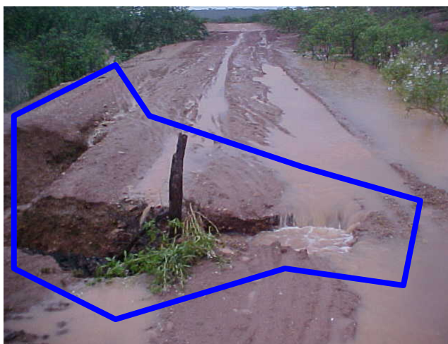
FIGURA 2.37: ESTRADA ROMPIDA DEVIDO À EROSIÃO (ALTO NÍVEL DE SEVERIDADE)
