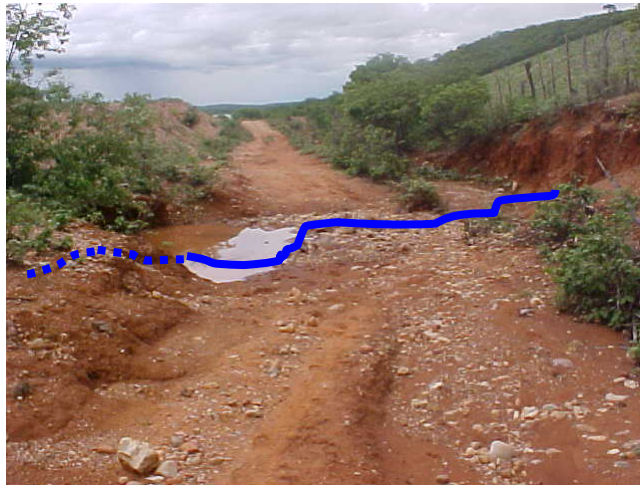
FIGURA 2.25: EXEMPLO DE BURACOS (ALTO NÍVEL DE SEVERIDADE)
