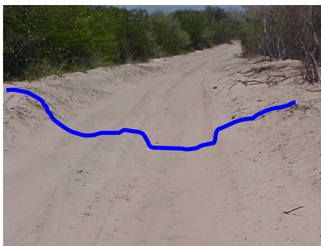
FIGURA 2.34: ESTRADA COM ALTO NÍVEL DE SEVERIDADE (AREIÕES)
