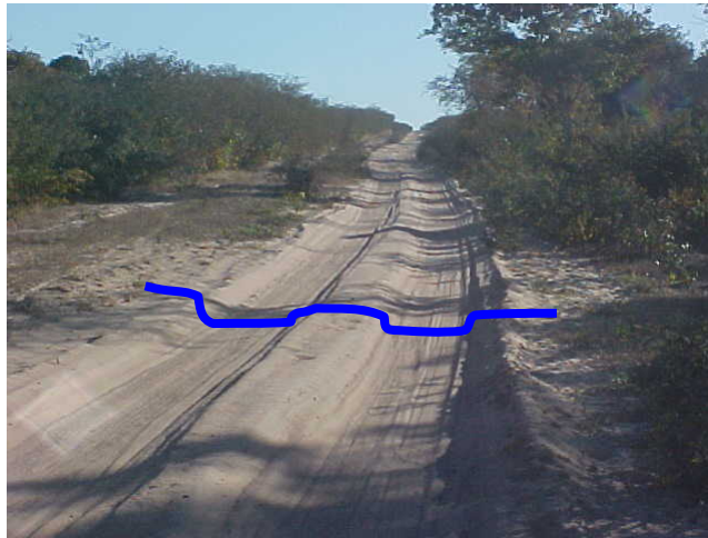
FIGURA 2.29: ESTRADA COM MÉDIO NÍVEL DE SEVERIDADE (AFUNDAMENTO DE TRILHA DE RODA)
