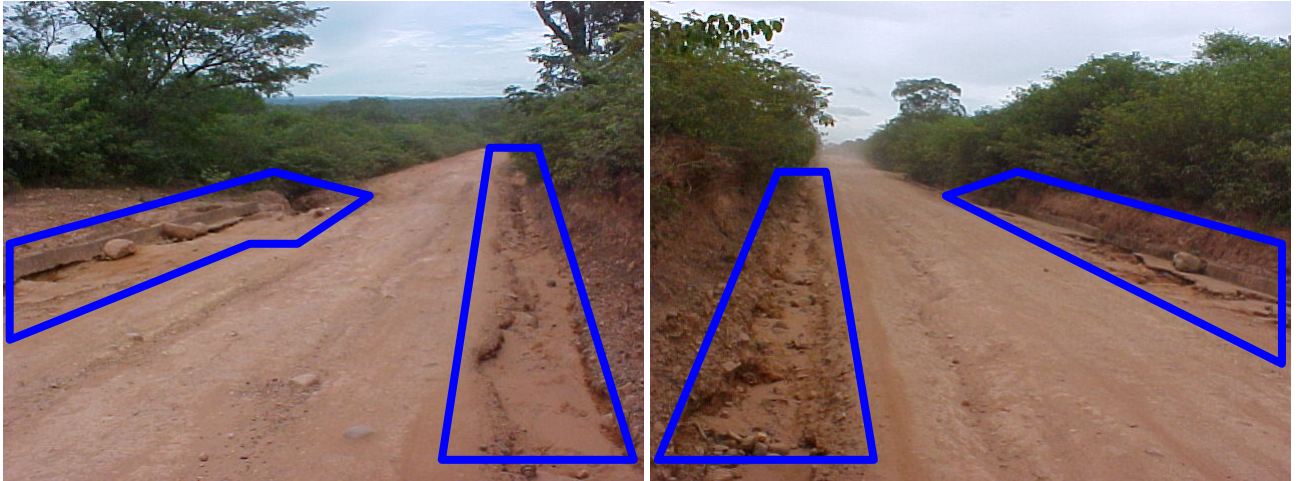
FIGURA 2.13: DRENAGEM INADEQUADA – VISTAS INVERTIDAS DE UM MESMO TRECHO COM DANO
