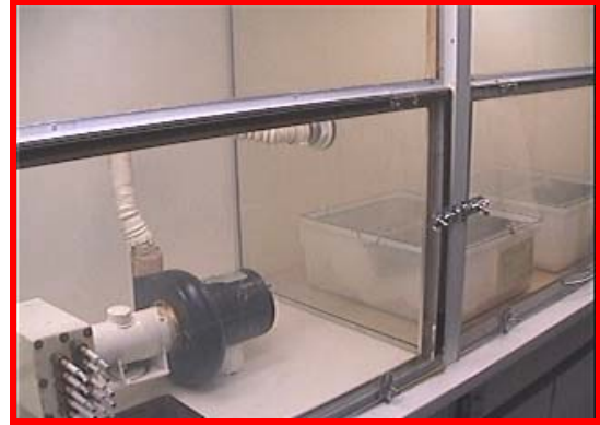
Figura 2 - Câmara de Contenção
