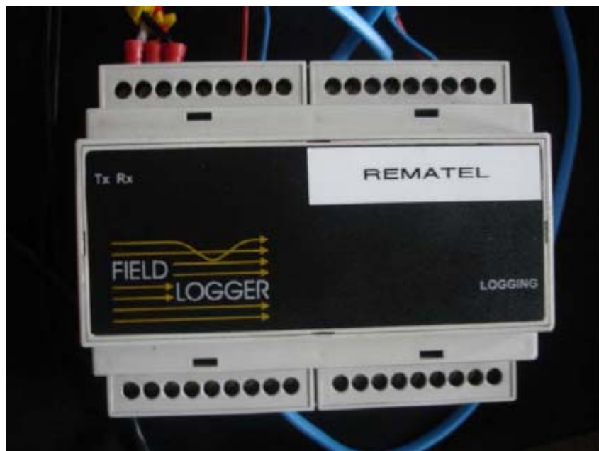
Figura 10 - Cabos de compensação unidos à placa de aquisição de dados do tipo field logger
