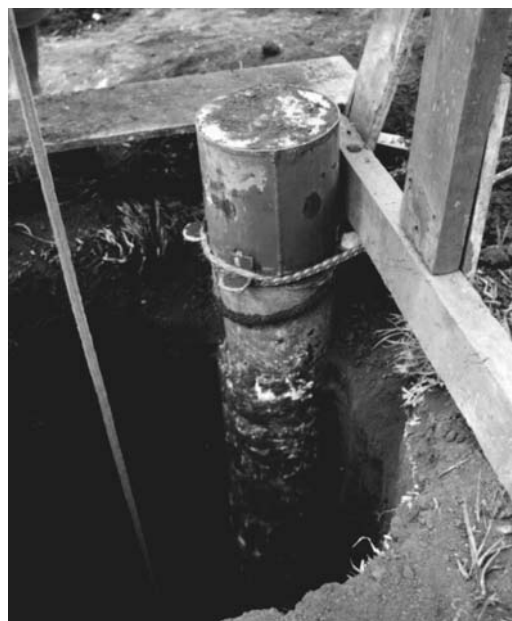
Figura 4.16 - Poço de inspeção PE4
