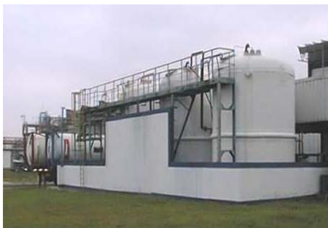
Figura 14 – Vista Externa da Estação de Pré-Tratamento de Efluentes
