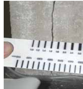
Figura 6.33 – Abertura da fissura.
