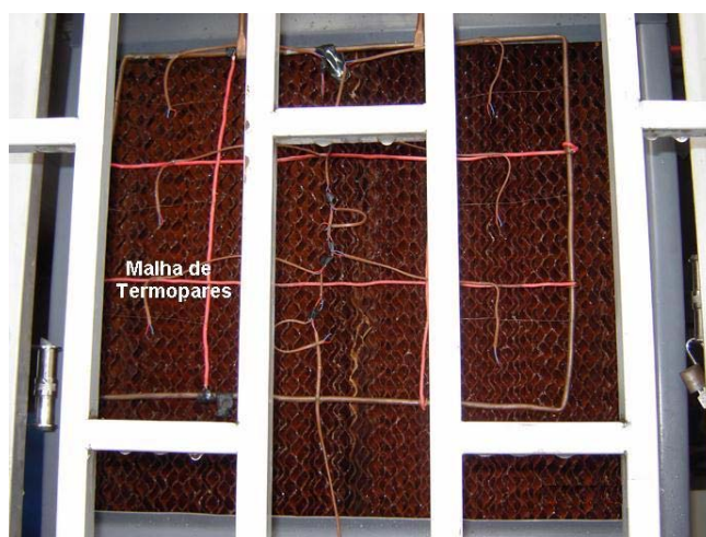
Figura 4.14 – Malha de termopares na entrada do ar no painel do resfriador
