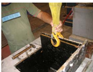
2º) Retirada da parte interna da fôrma com auxílio da ponte rolante
