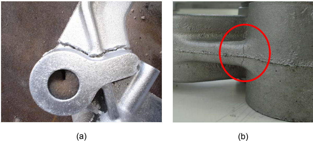
Figura 41 – Resultado da fundição com molde de cura a frio. (a) peça quebrada; (b) trincas.
